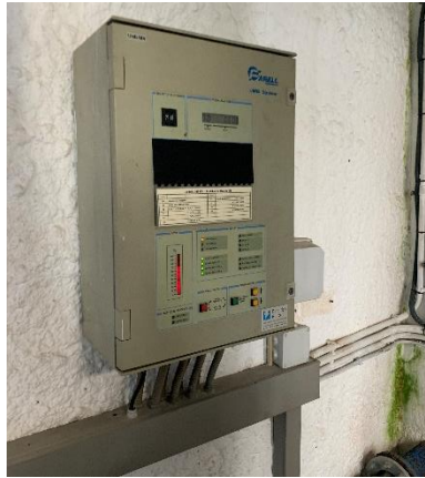
Figura 10. Telecontrol. Dipòsit Coll de la Manyà
