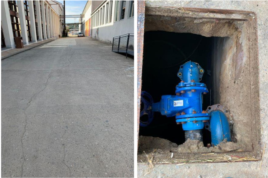
Figura 11. Part superior i entrada d'aigua al dipòsit Roca Umbert
