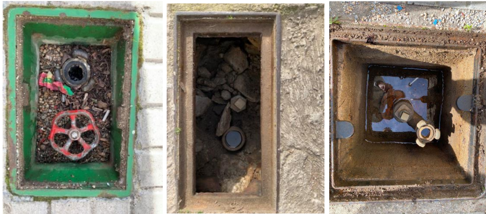
Figura 18. Diferents boques de reg instal·lades al municipi
