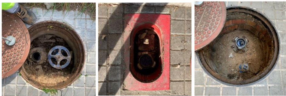
Figura 17. Hidrants soterrats en servei
