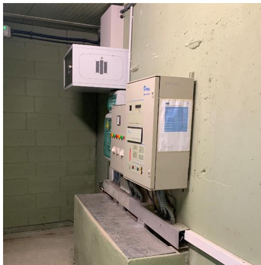
Figura 7. Telecontrol del dipòsit Puig de les Forques
