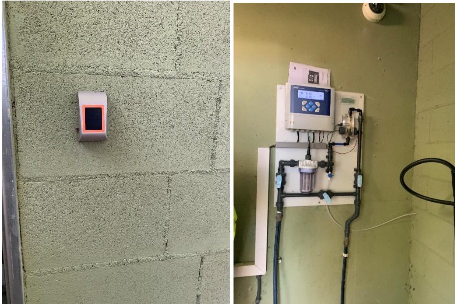
Figura 16. Control d'accés i analitzador fix multiparamètric. Dipòsit Puig de les Forques
